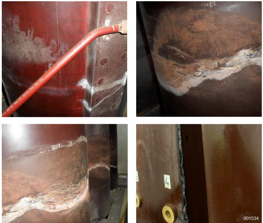
Fig. 24: Vestígios de correntes de fugas e de descargas parciais
