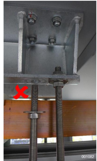
Îmbinare filetată slăbită
