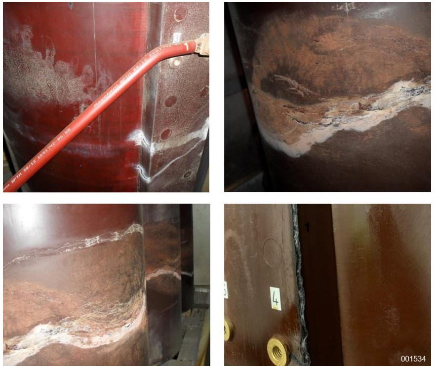
Fig. 24: Urme de descărcare și urme de descărcare parțială
