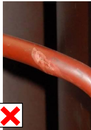
Fig. 11: Nu este permis! Izolație deformată a unei conexiuni de cuplare
